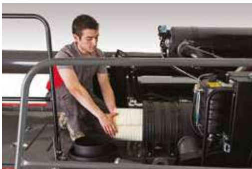
Проверка и очистка воздушного фильтра
